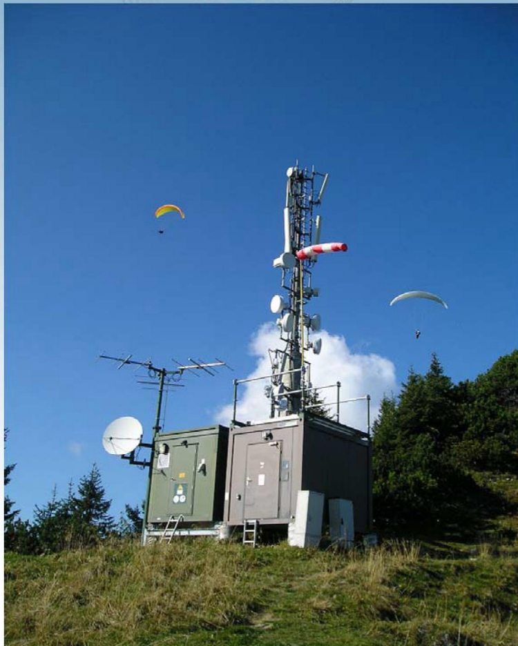
UKW-Sendeanlage für österreichische Privatradios am Hahnenkamm bei Reutte in Tirol. Photo: Matthias Hornsteiner
